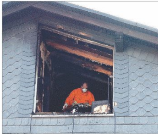
Einen geschätzten Schaden von rund 100 000 Euro richtete der Brand eines Dachstuhls in einem Wohnhaus in Kausen an. Sachverständige suchen nach der Brandursache. ■ Foto: Döring
