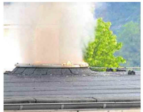
An dieser Luke auf dem Dach des Krankenhauses nagen die Flammen. Die Rauchentwicklung ist weithin zu sehen. Fotos: Bernhard Theis
