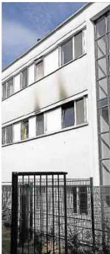
Die Spuren des Feuers sind an der Krankenhausfassade zu sehen.
